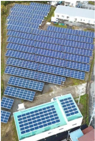
太陽光発電所
