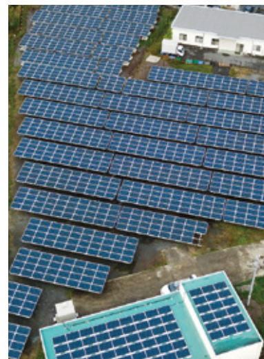
高崎倉賀野発電所（最大発電出力407kW）
